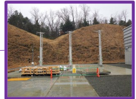
フレアスタック
