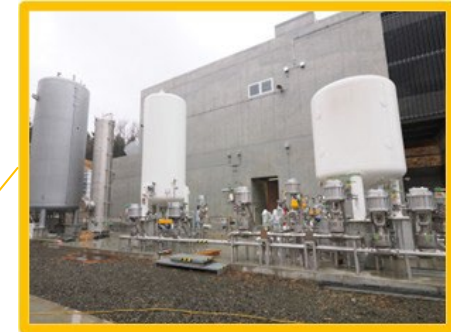
燃料系高圧・低圧ランタンク
