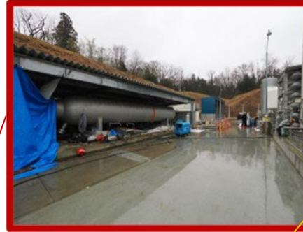
ガス水素気蓄器
