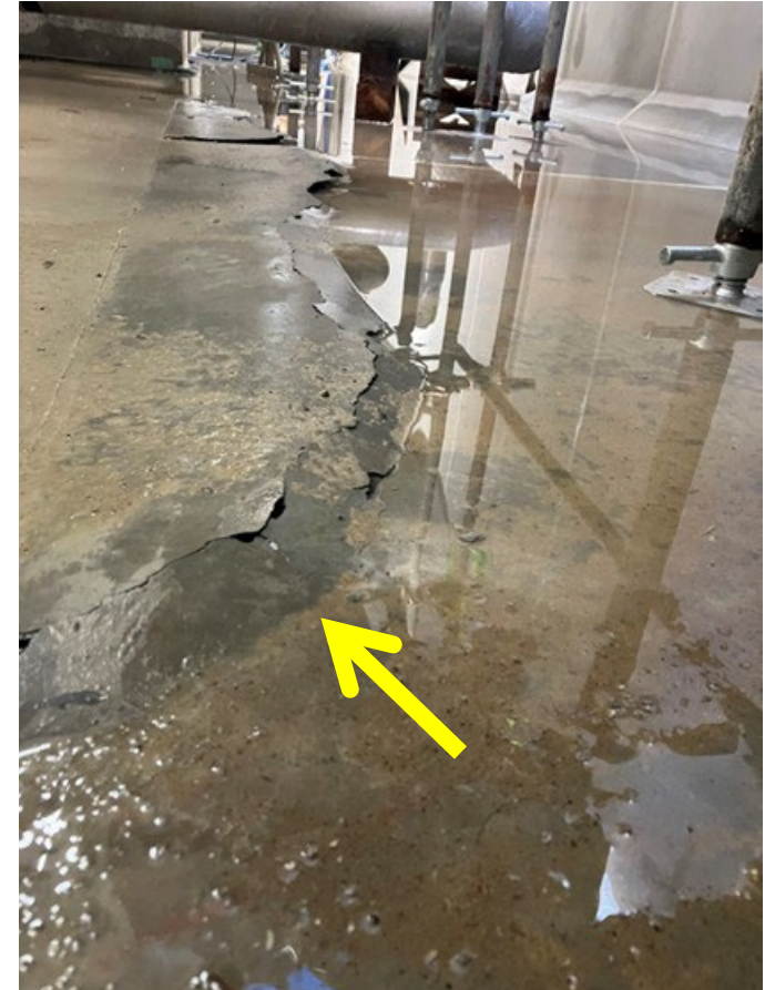
コンクリートの割れと床面隆起
